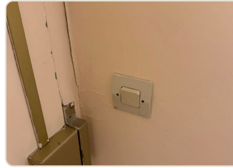
Interrupteur et verrou de la porte d'entrée
