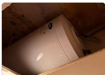
Cumulus actuel au-dessus du faux plafond du vestibule, à déposer
