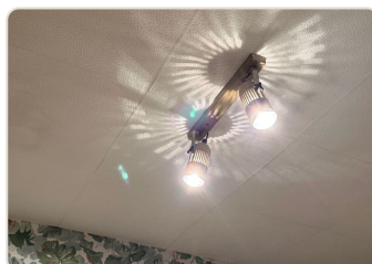
Salle de bain : plafond en dalles et spots à déposer
