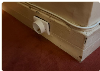
Prise sur plinthe avec câble apparent
