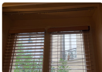
Tringle et cache bois à déposer, stores à refixer
