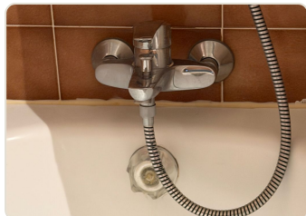
Robinetterie de baignoire à remplacer, joints à refaire
