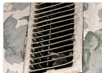
Grille du conduit de la salle de bain, sans extracteur
